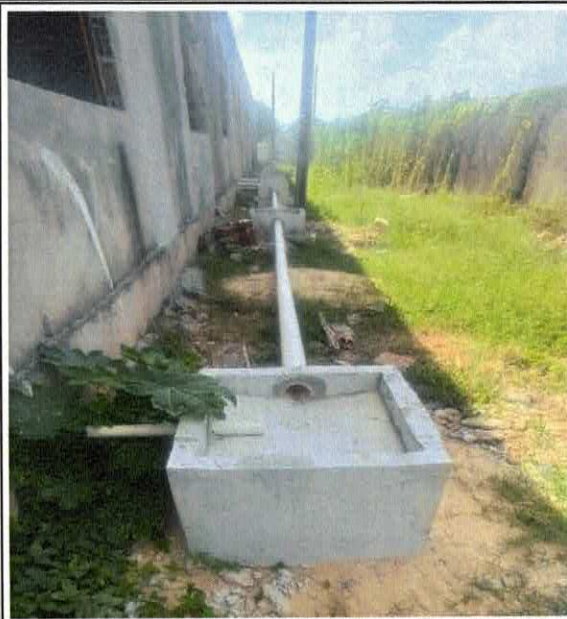
FOTO 18: CAIXA DE CONCRETO ARMADO PRE-MOLDADO, COM FUNDO E TAMPA, DIMENSÕES DE 0,60 X 0,60 X 0,50 M
