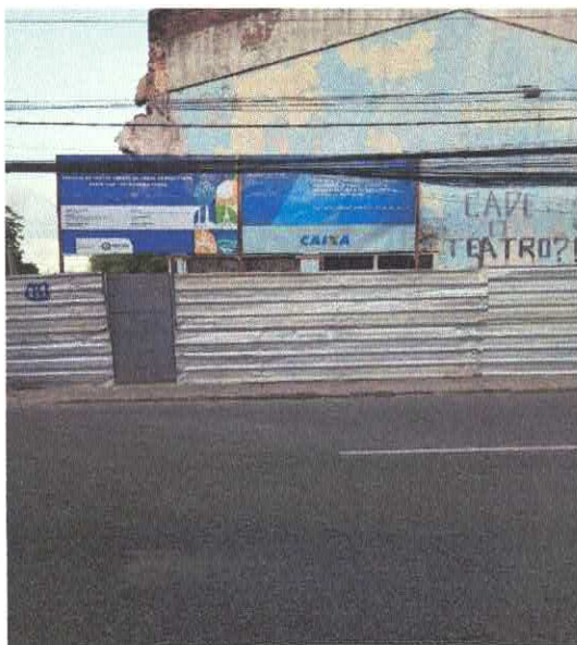
FOTO 01: PLACA DE OBRA EM CHAPA DE AÇO GALVANIZADO.
